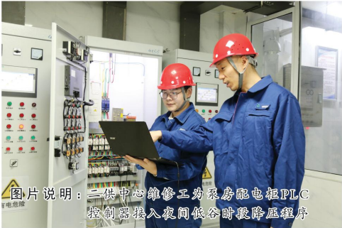
图片说明：二供中心维修工为泵房配电柜PLC控制器接入夜间低谷时段降压程序
